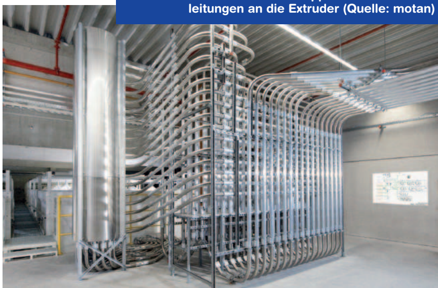
Zwei vollautomatische Kupplungsbahnhöfe des Typs Metrolink ziehen Material aus 24 Silos und verteilen es über knapp 2000 Meter Rohrleitungen an die Extruder (Quelle: motan)
