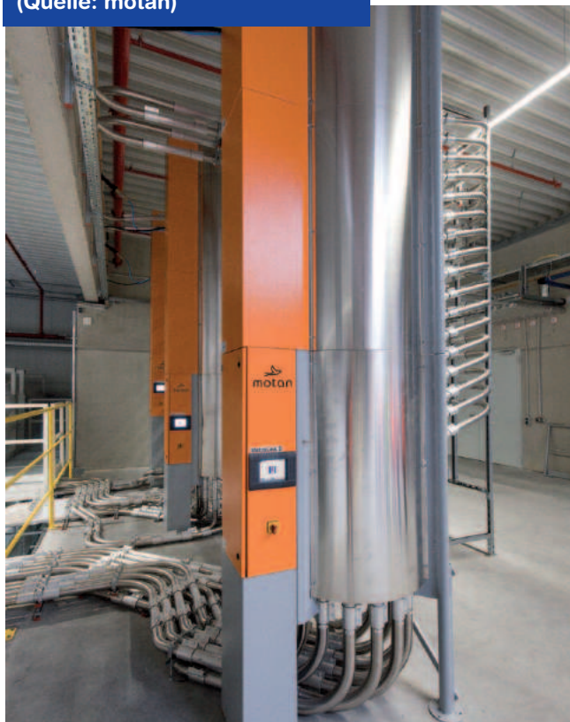
Vollautomatischer Kupplungsbahnhof Metrolink (Quelle: motan)
